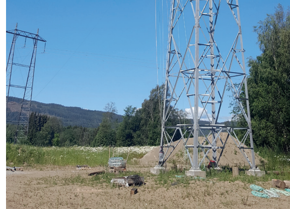
NYUTVIKLET: Prototype utviklet av Sweco for Statnett. De nye standardmastene vil ha en høyde fra 16 til 38 meter.
